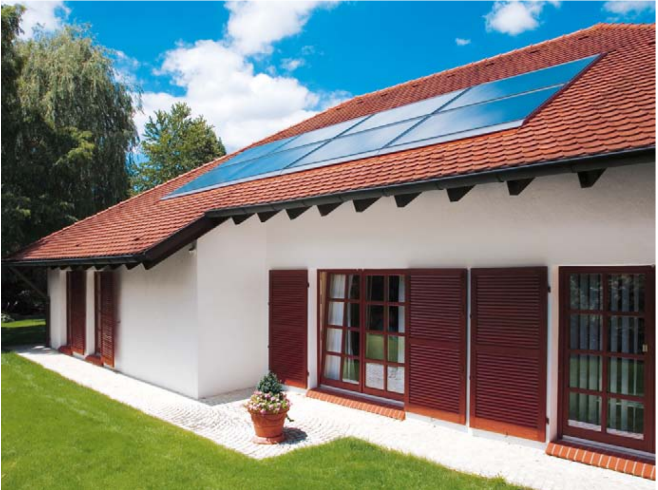
Kollektoranlage zur kombinierten Trinkwassererwärmung und Heizungsunterstützung
